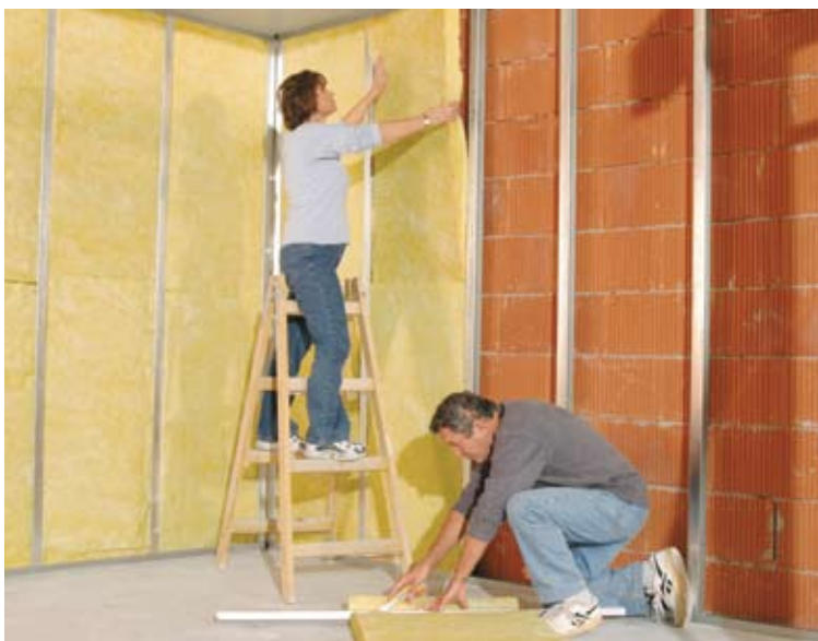
Vyplňování lehké kovové konstrukce minerální izolací Isover Piano. Klíčové pro výsledný izolační efekt je precizní provedení bez mezer a dutin (RIGIPS)
