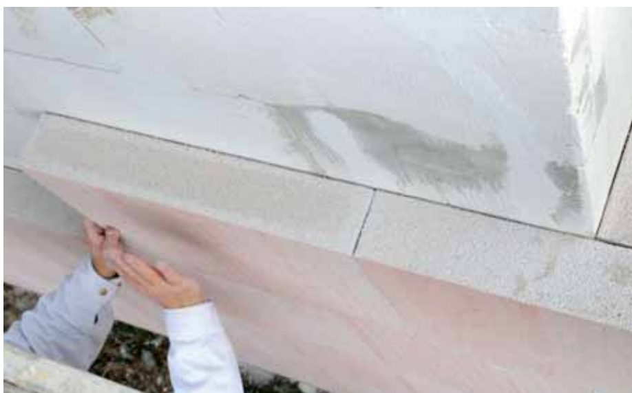
Tepelněizolační sendvič s nosnou stěnou z pórobetonu P2-400 doplněný z vnější strany izolačními deskami Ytong Multipor
