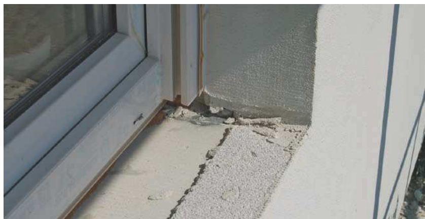
Skladba 375 mm P2-400 + 100 mm Ytong Multipor o celkové tloušťce 475 mm dosahuje součinitele prostupu tepla U = 0,176 \text{ W/m}^2\text{K} a má parametry pro vysoce nadstandardní NED. Při tloušťce izolačních desek 150 mm by již skladba dosáhla doporučených hodnot pro pasivní domy
